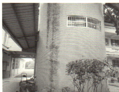
104年度校舍防水 ~工程改善前
