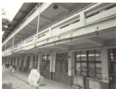
104年度校舍防水 ~工程改善前
